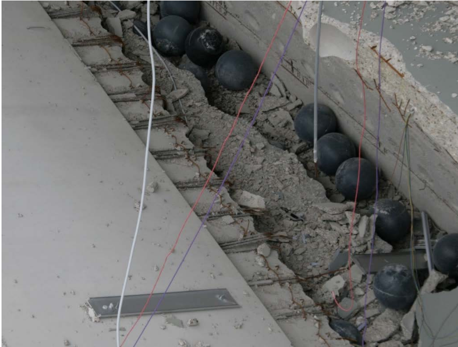
foto 8 Onderzijde bezwiken vloerdeel met aan de rechterzijde de uitstekende koppelwepening en een deel van de druklaag
