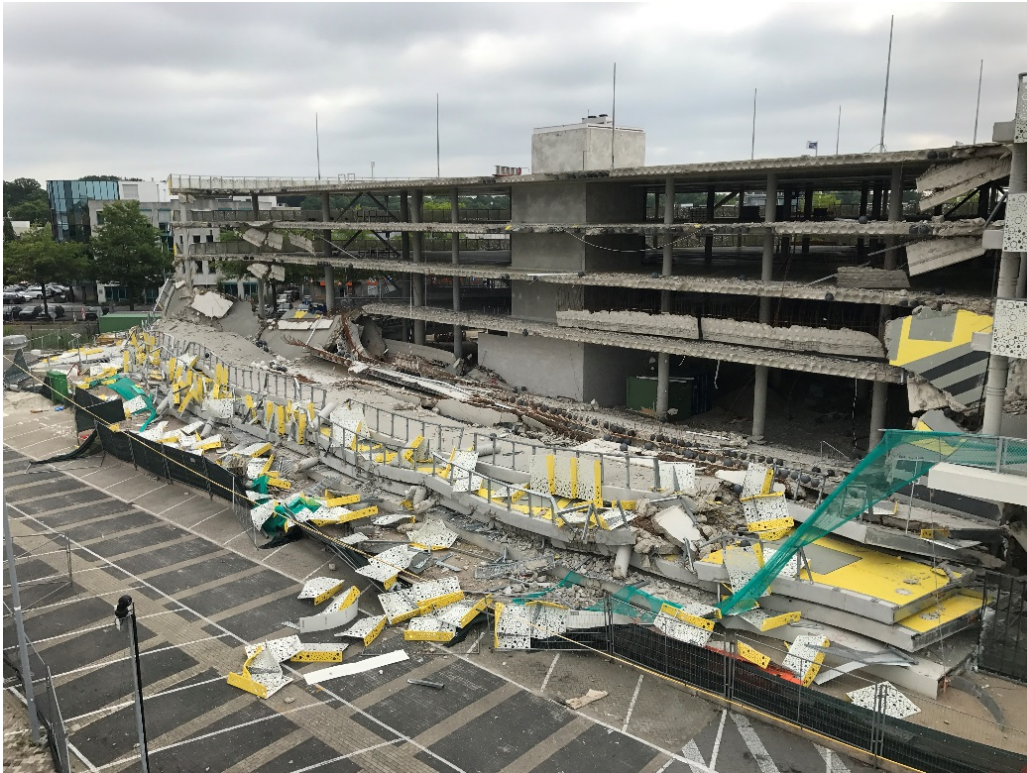
foto 1 Overzicht van bezwiken deel van de constructie
